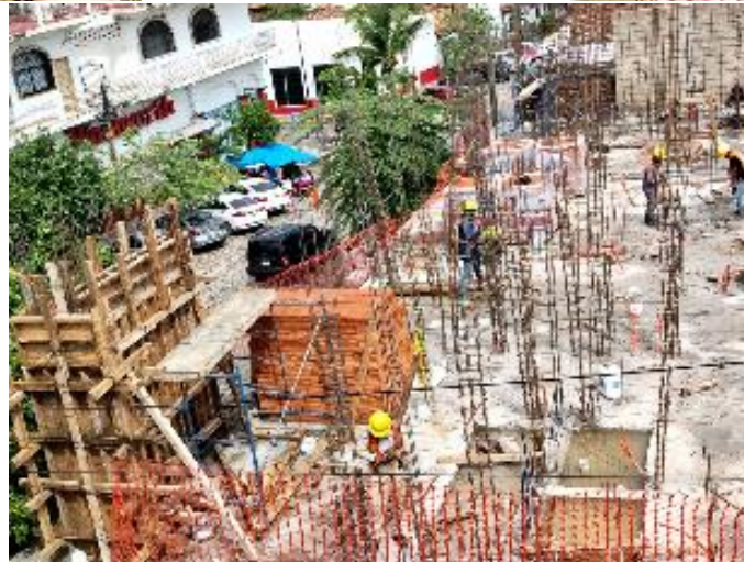
Levantar muros de Novaceramic en deptos. de 1er nivel con castillos de refuerzo
